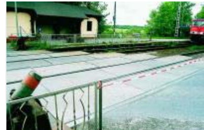
Die Überreste des abgebrochenen Schrankenbaums und dessen vorläufiger Absperrband-Ersatz am Bahnübergang Schwarzkollm. Foto: Norbert Keipert
