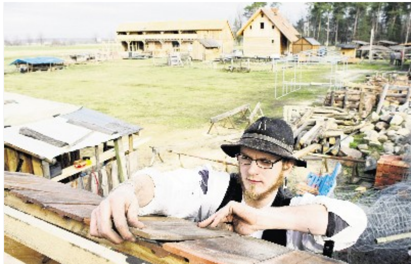
Wandergeselle Tommy, Zimmerer aus Berlin-Köpenick, ist bereits zum dritten Mal auf der Baustelle der Krabatmühle und gerade mit dem Eindecken eines Holzschuppens im hinteren Teil des Geländes beschäftigt. Er hat auch das Geländer für die Galerie des Laubenganges (im Hintergrund) gebaut. Foto: Gernot Menzel
